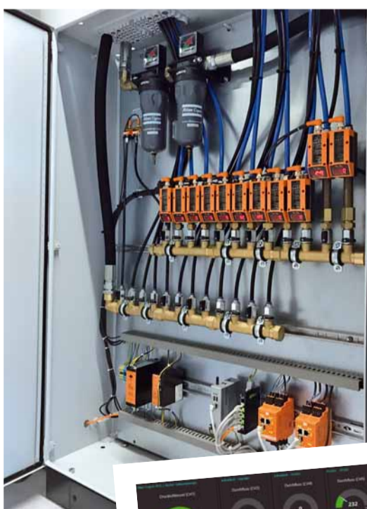
Verbaute ifm-Sensoren in der zentralen Steuereinheit des Reinraumlabor.
