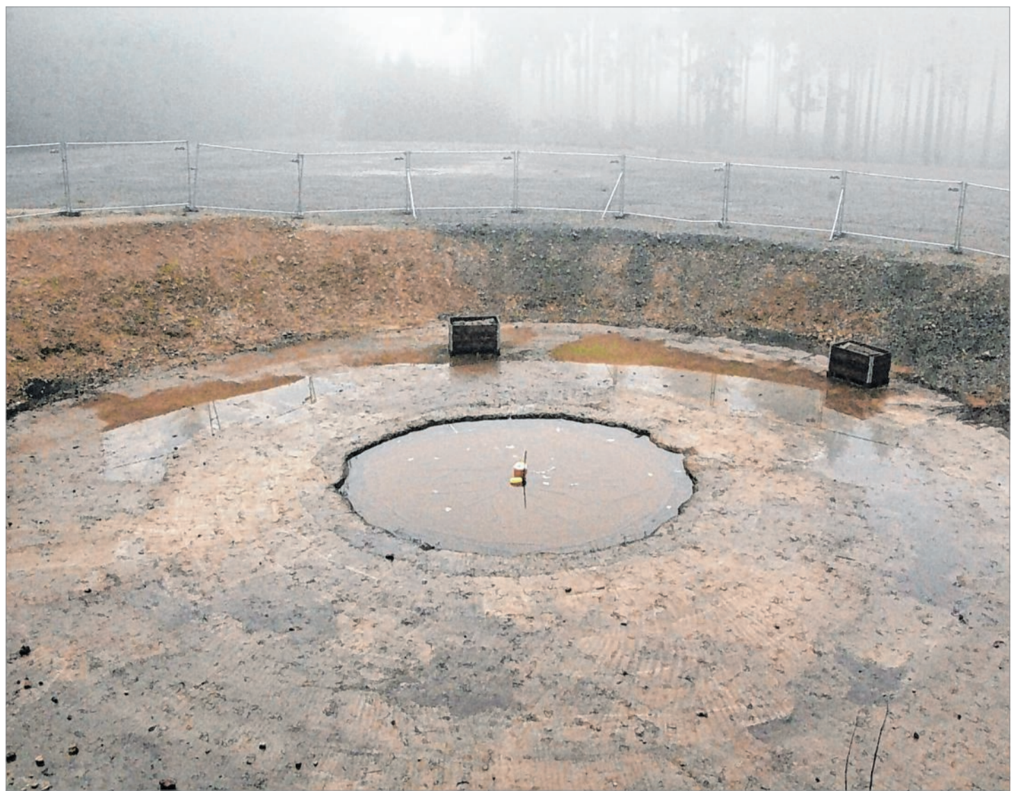
Die Bewehrungskörbe, die einst schon installiert waren und auf Beton warteten, sind längst demontiert worden. Sie sollen später durch neue Fundamentbewehrungen ersetzt werden – aber wann? Die Frage erscheint völlig offen. Fotos: Björn Weyand
